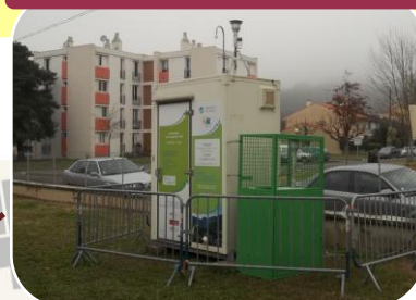
Station de mesures Moissac
