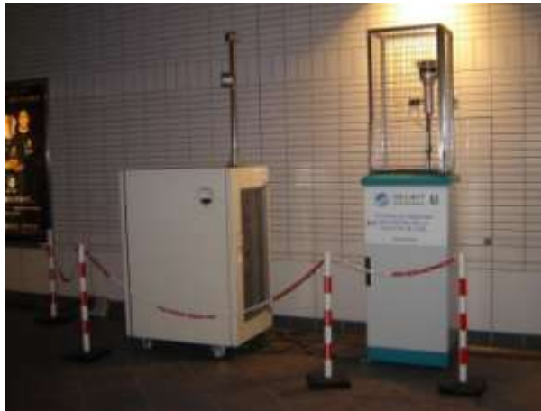
Photo 1 : Station de mesure provisoire sur le quai d'une station de métro
