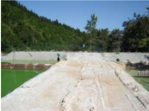
Site n° 98 : Bassin de rétention
